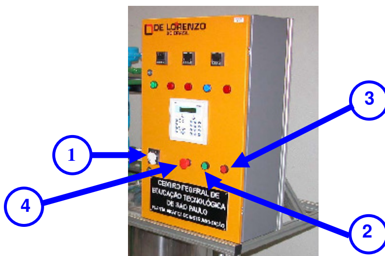
Figura 11 – Painel de comando
